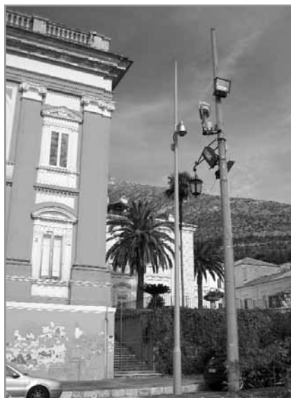
Telecamere installate all'esterno del Complesso Monumentale del Belvedere - San Leucio.
